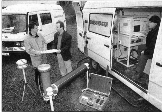
Uwe Jilek (Mitte) von der Uni und die Stadtwerke-Mitarbeiter Jens Kliemt (l.), und Dirk Salzmeser bei der Vorortprüfung von Mittelspannungskabeln, die im Erdreich verlegt sind. —Foto: TU/UWE MEINHOLD
